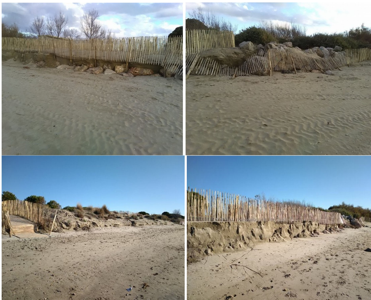
Illustration 31 – Erosion dunaire et dégâts sur les ganivelles dans le secteur de l'ancien hopital du Boucannet.
