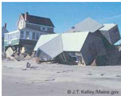
Figure 10 : Erosion dans le Maine
