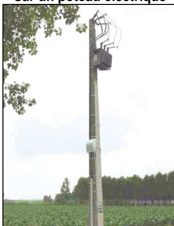
Photo 5 : Transformateur électrique situé en hauteur, sur un poteau électrique
