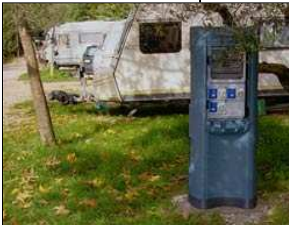
Photo 4 : Branchement électrique en hauteur
